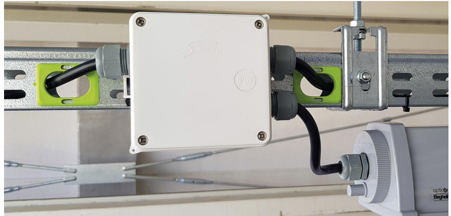
Puszka naścienna N90x90S z wkręcanyimi dławnicami, zastosowana na kanale kablowym
