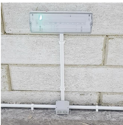
Rozgałęzienie prądu przy pomocy puszeki typu N80x80F
